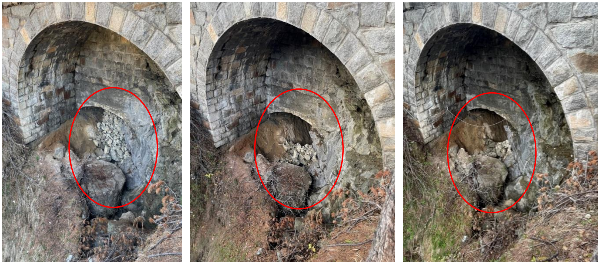
Nach wie vor verschwindet das Lockermaterial unterhalb der Lehenkonstruktion, welche die Via da Mulin stützt. Um das Problem auch längerfristig zu lösen, ist eine umfangreiche Sanierung nötig. Fotos von links nach rechts: Mai 2022, November 2022 und Mai 2023.
