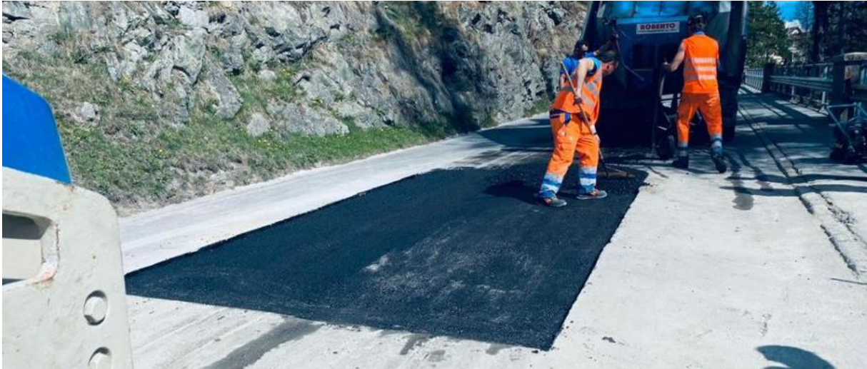
Mitte Nachmittag am 12. Mai 2022: Der Strassenbelag wird eingebaut, anschliessend konnte die Via da Mulin wieder geöffnet werden.
